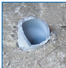
Broken conduit on jobsite
